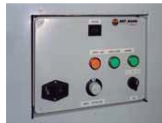
CUADRO ELÉCTRICO CON REGULADOR DE VELOCIDAD PARA EL EXTRACTOR DE HUMOS.
