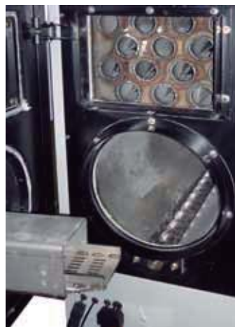
INTERCAMBIADOR Y CÁMARA DE COMBUSTIÓN CON SIN FIN DE EXTRACCIÓN DE CENIZAS.
